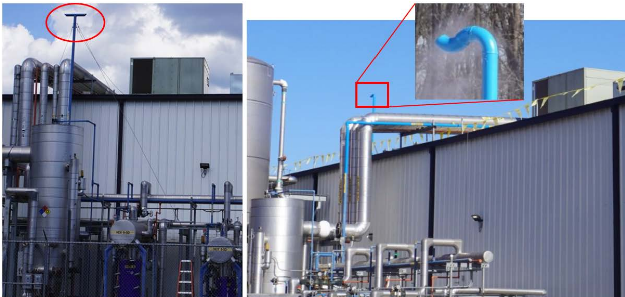
Figura 29: Tubería de descarga atmosférica del Tank Park 5, antes (izquierda, marcado con un círculo) y después (derecha, y recuadro) del incidente. (Crédito: CSB)
