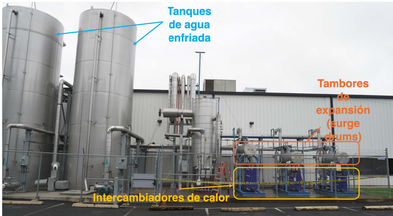
Figura 4: Los tanques de agua enfriada, los tambores de expansión y los intercambiadores de calor en el Tank Park 5. (Crédito: CSB)
