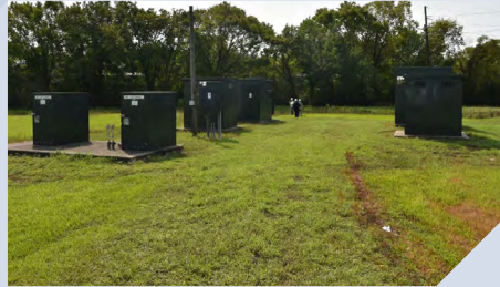
Transformadores en la instalación.
